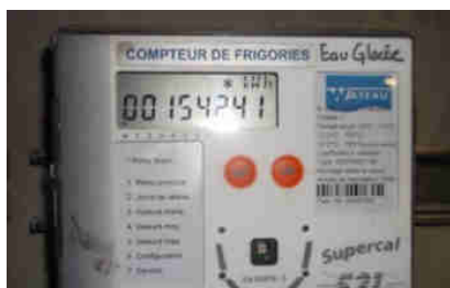
Figure 7 - Compteur thermique ELSTER Supercal 531
