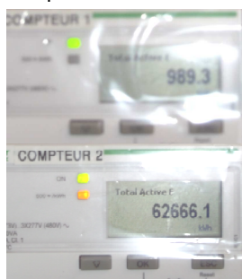
Compteur électrique chaudière (haut) et PAC (bas)
